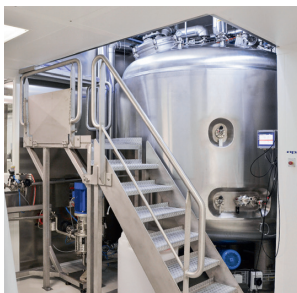
▲最新の 5,000 L 培地タンク (CIP/SIP システムを搭載)
