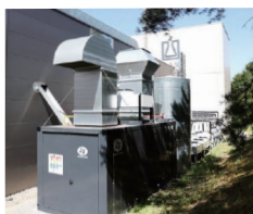
熱電供給ユニットで発生する熱を利用して自家発電
