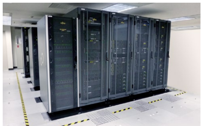
サーバーラック
