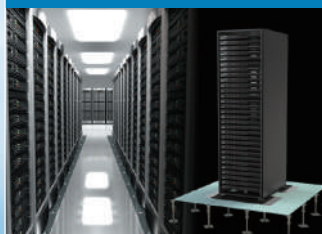
サーバー／データセンター
